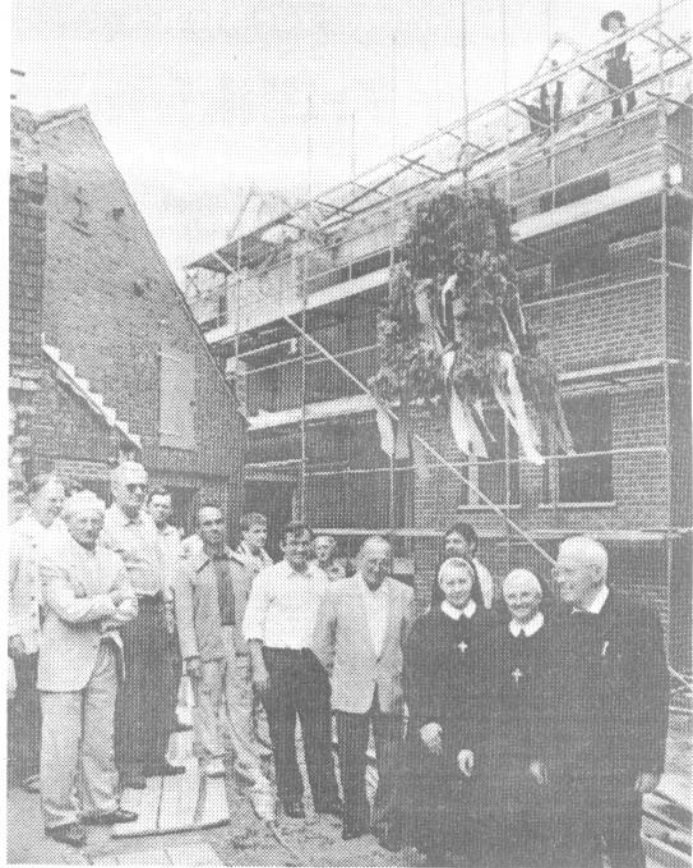
Richtfest wurde gestern beim Neubau des Altenheimes am Hubertus-Stift in Schiefbahn gefeiert. Pfarrer Dr. Bernhard Brück und Oberin Josefa (v.r.) freuten sich über den schnellen Fortschritt des 4,5-Millionen-Baus, dessen Grundstein erst im März gelegt wurde. Im Frühjahr soll der Neubau fertig sein.
